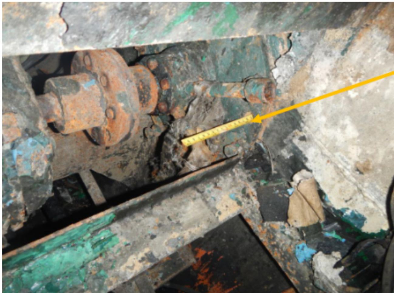
图 6 泵舱右压载泵穿舱轴法兰盘图（缺少一根螺柱，螺柱孔直接贯穿舱壁）
