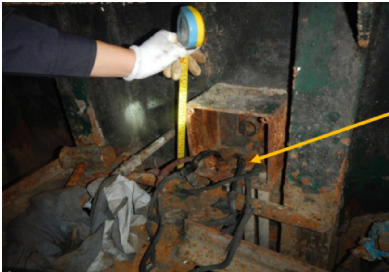
图 7 泵舱右穿舱电缆管图（穿舱电缆密封不严）
