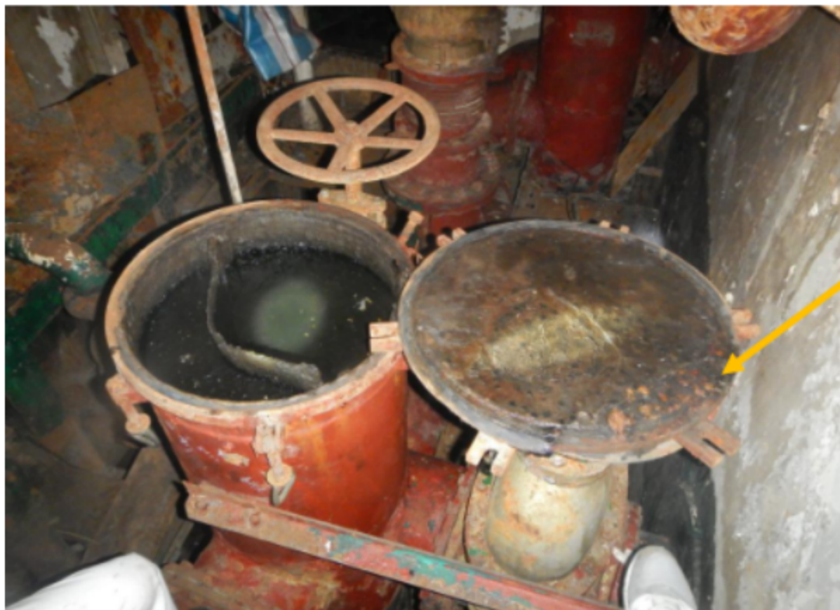
图 5 泵舱货油管滤器内部图（压盖密封胶垫破损缺失约 1/4 长度）
