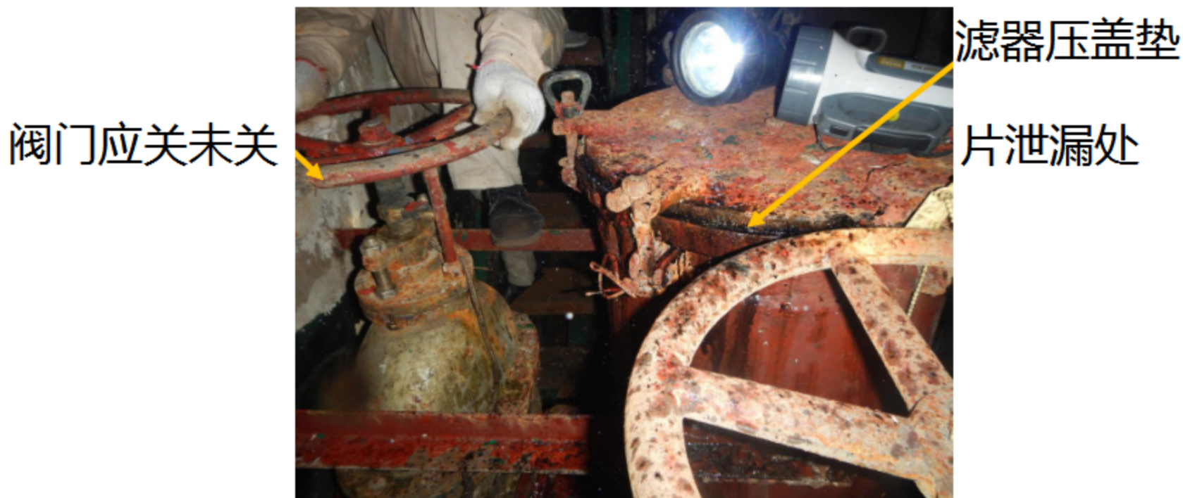
图 4 泵舱货油管闸阀及滤器图
